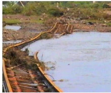
(D) Collapsed railway line - Nagore
